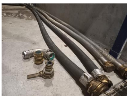
N-pentán lefejtéshez használt tömlők és csatlakozók
